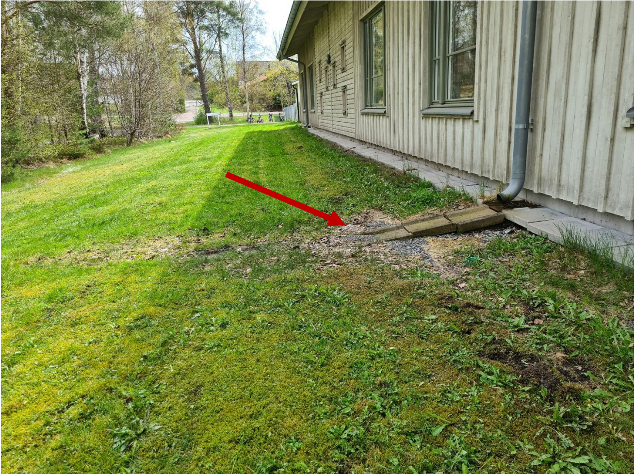
Figur 13. Röd pil indikerar var plattorna för avrinning från stuprören satt sig under omgivande marknivå. Notera även att stuprören mynnar ovan mark. Ingen dränering bedöms således finnas under byggnaden.
