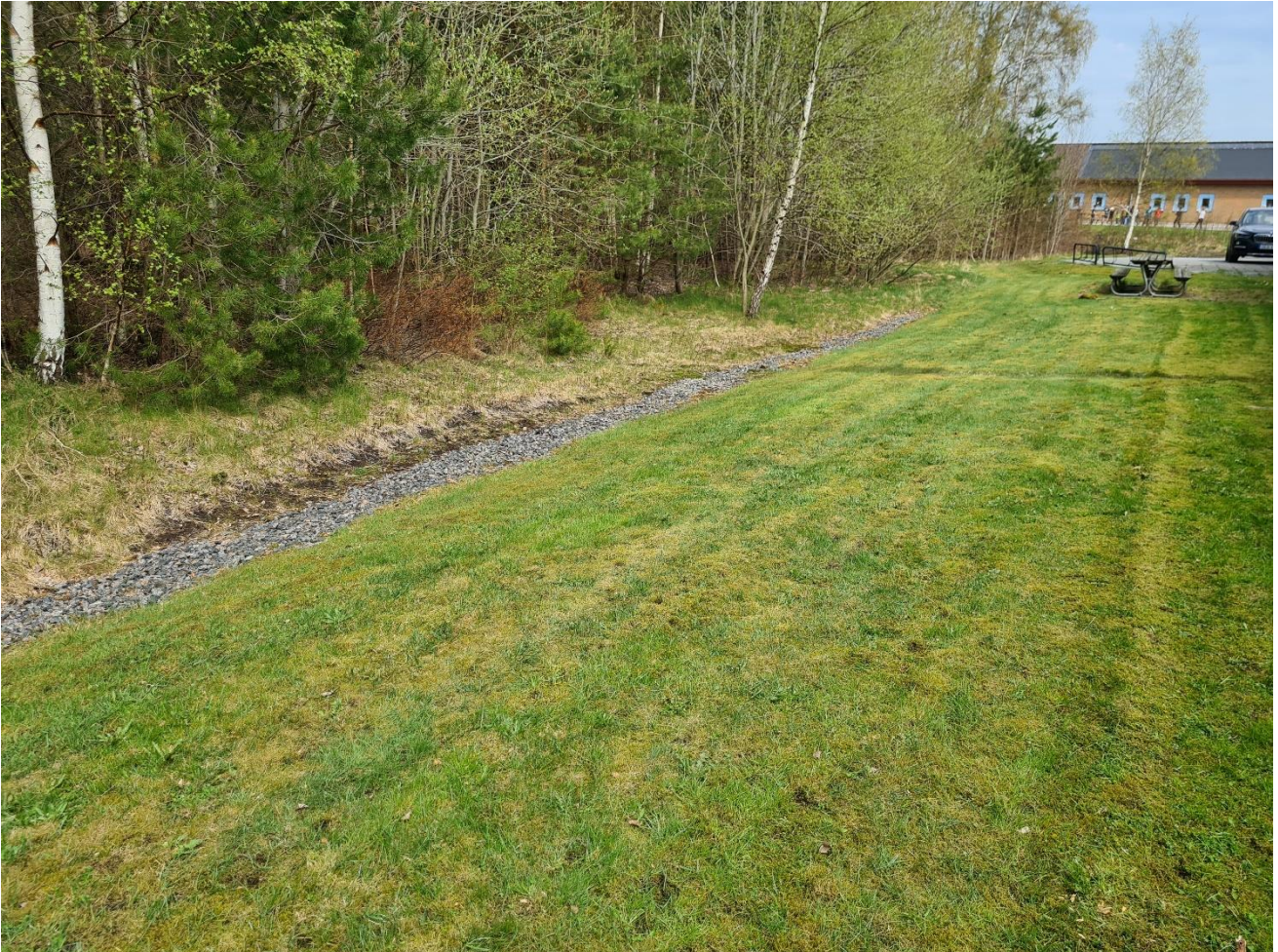
Figur 8. Förekommande kross-/täckdike i anslutning till förskolan. Orsaken bedöms vara att förhållanden varit besvärande blöta innan
