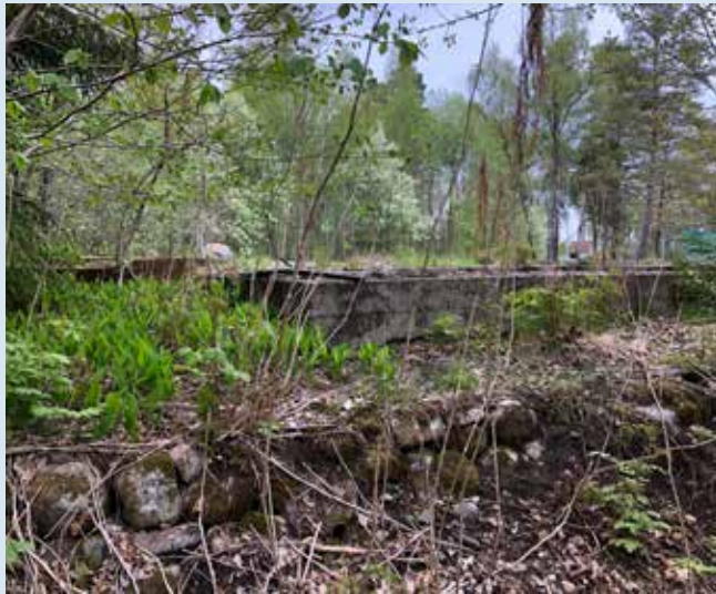
Stödmur med mindre, naturligt formade stenar längs Fjällstedsvägen inom fastighet 1:3. Ovanpå ligger gjuten betonggrund för tennisbana.
