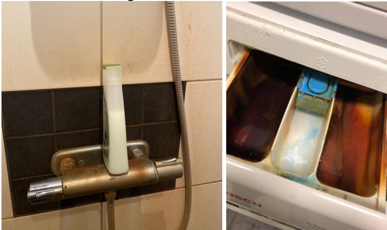
Exempel på de avlagringar som uppstår p.g.a. dåligt vatten.
