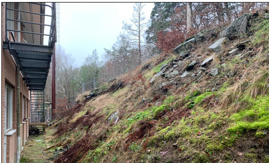
Figur 6. Norr om skolan finns en slänt som delvis syns som en skärning och delvis en jordig blockslänt. Här finns mindre block och stenar som fallit ut mot skolans norra fasad. För blockens position, se grön oval i Figur 3.
